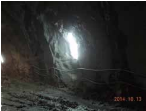
● 坑內照明、電線架高
