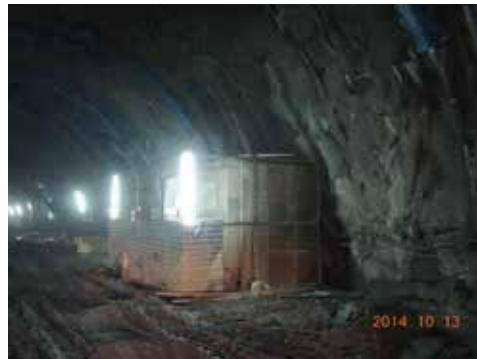
● 洞內供電設備
