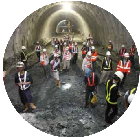
● NS3.NN5隧道貫通後相關隧道施工隧道團隊人員合影留念及隧道內景象
