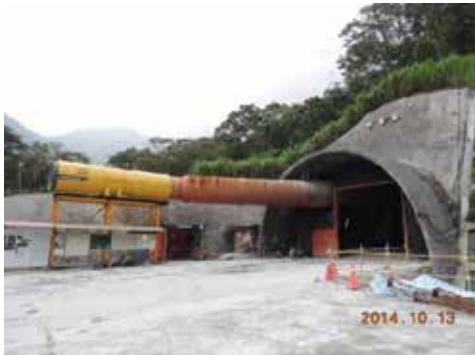
● 洞外大型送風機
