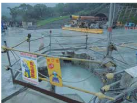
● 隧道內排水集中處理
