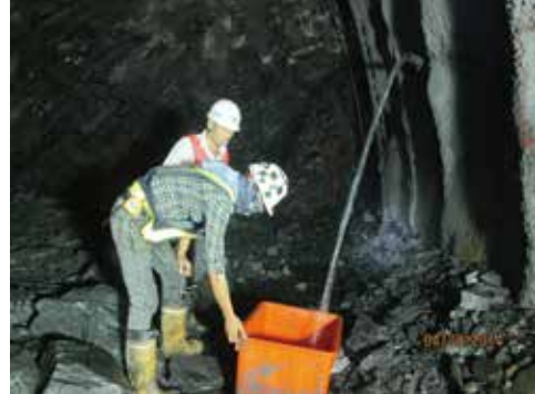
● 103.08.04 僅餘T701 RT側局部出水
