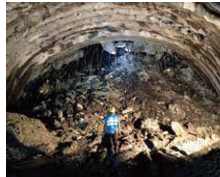
• 6k+156.4大規模坍塌後情形
