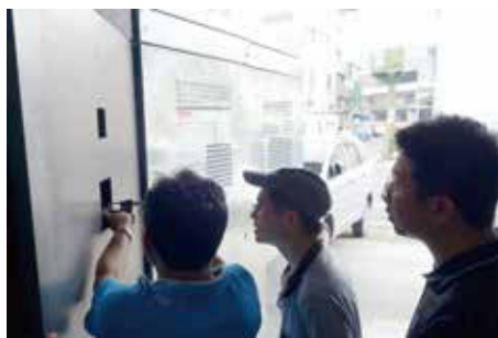
• 105年5月27日偕同監造辦理東岳隧道南口機房配電盤中檢查
