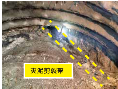
• 6k+156.4東側剪裂帶及初始坍塌
