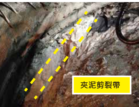
• 6k+156.4西側剪裂帶及初始坍塌
