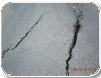
裂縫擴大狀況照片
