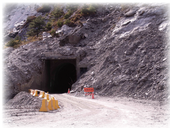
台20線147.515K處大關口隧道災後搶通現況
