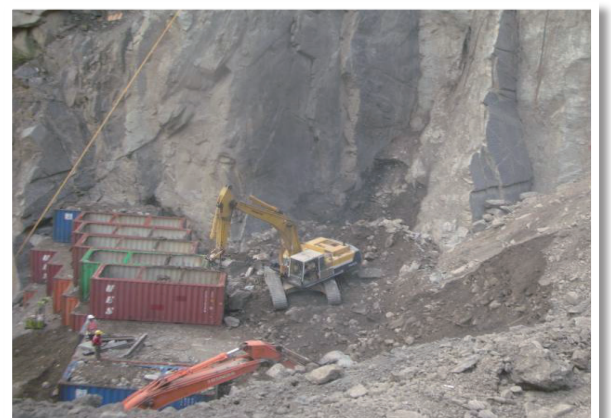
122.5k路基流失處，上下岩壁垂直各200公尺以上缺口，工程困難度極高，上邊坡隨時可能落石坍方
