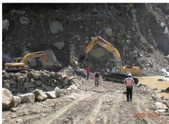
工程人員在台21線112k路基流失處搶通便道
