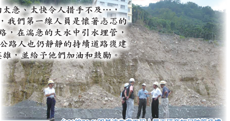
台21線79.9k路基流失處工程人員正研商如何防範危樓墜落方案
