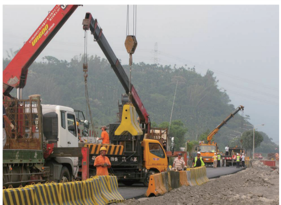
台16線10.4k路基流失處動員車械全力搶通
