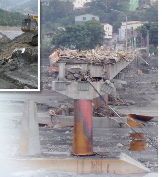
六龜大橋斷橋及橋面堆滿漂流木
