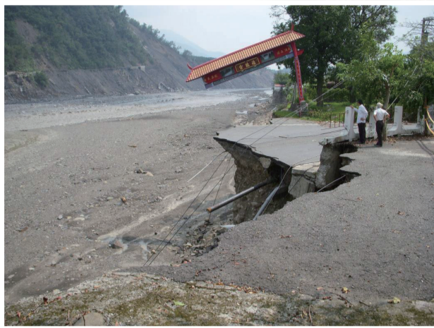
98.08.19局長勸查台20線寶來地區道路損壞狀況
