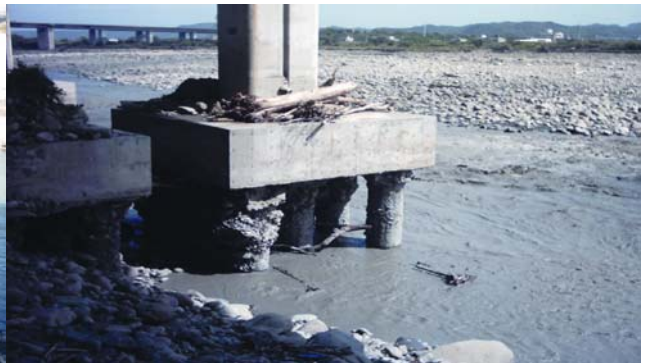
照片4 橋基裸露4
