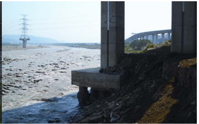
照片2 橋基裸露2
