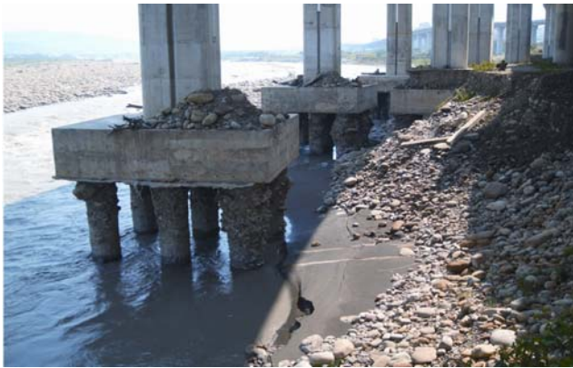
照片1 橋基裸露1
