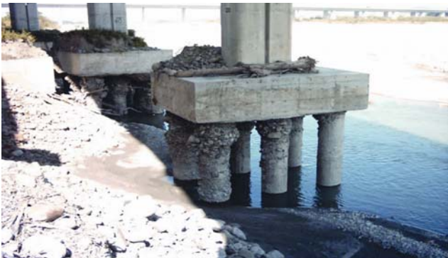
照片3 橋基裸露3
