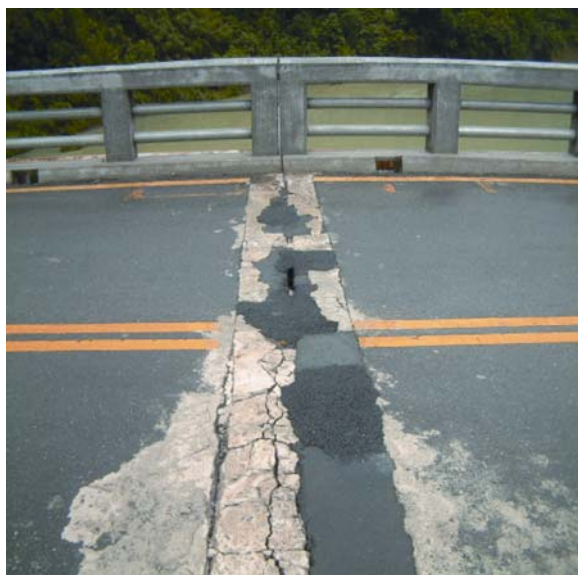
圖3.13 後續伸縮縫碎裂嚴重
