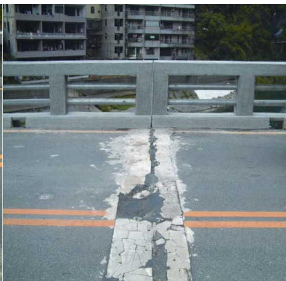
圖3.14 後續伸縮縫碎裂嚴重
