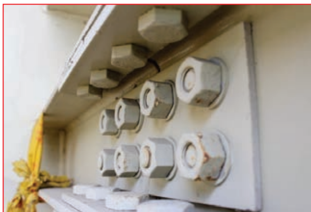
圖 3-29 螺栓長度不足
