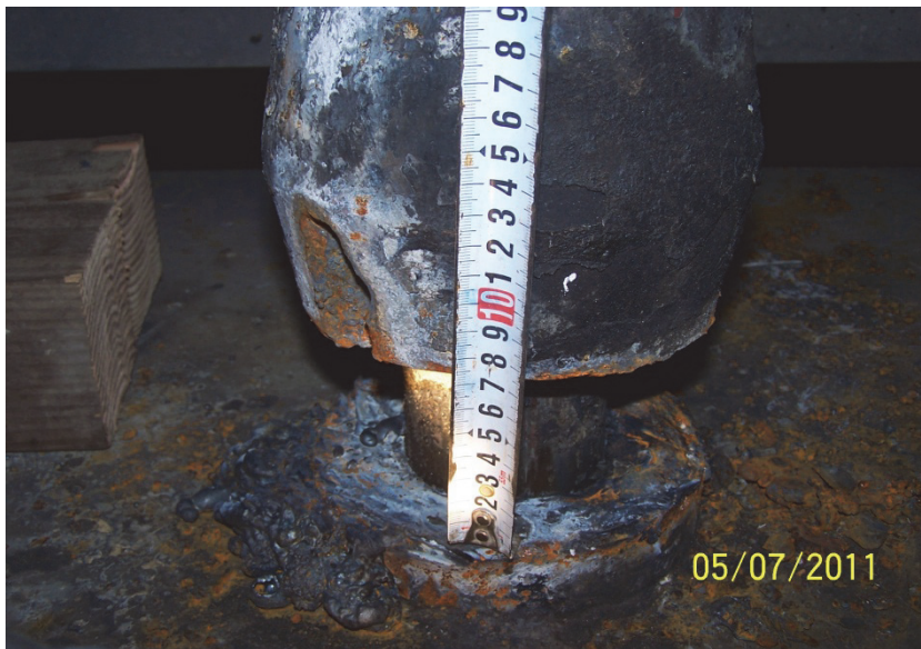
照片 8 承座切開後距離下方墊片有 6 公分
