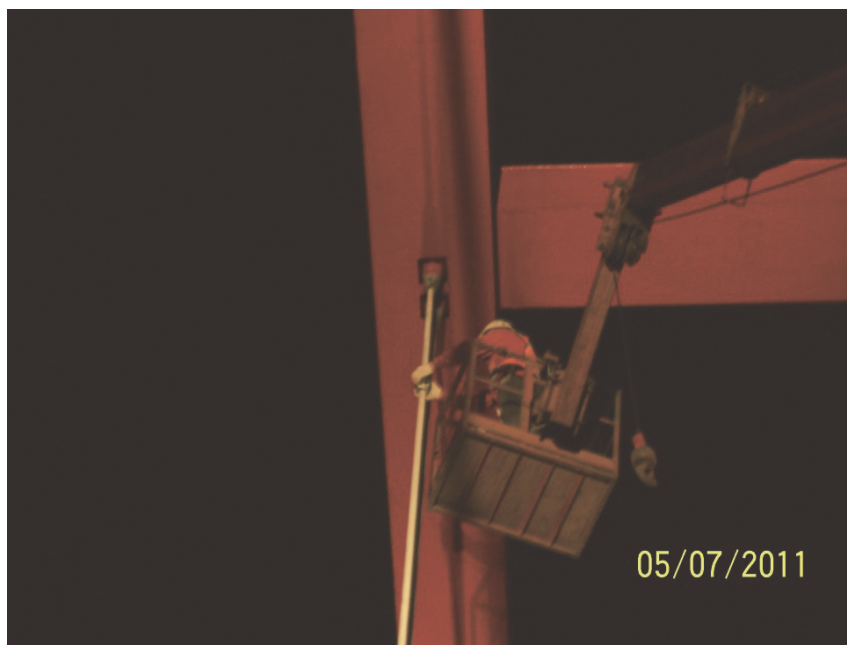
照片 11 拆卸吊索前先於上端安裝可承受一受力點裝置，避免吊索拆卸後因重力砸傷下方工作人員
