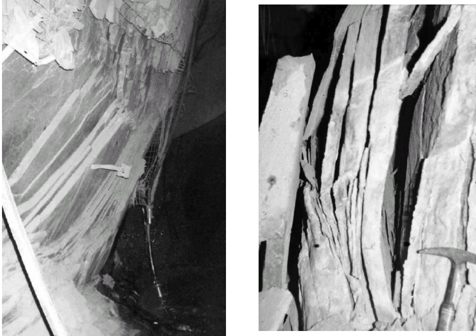
圖 4 隧道側壁岩盤脆性剝裂破壞(Spalling)情況
