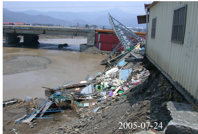
圖 3 楓港大橋因橋台沖刷而產生破壞
