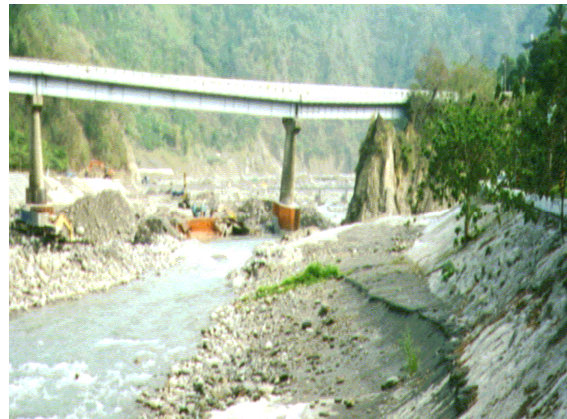
圖 10 寶來一號橋受賀伯颱風傾倒情況
