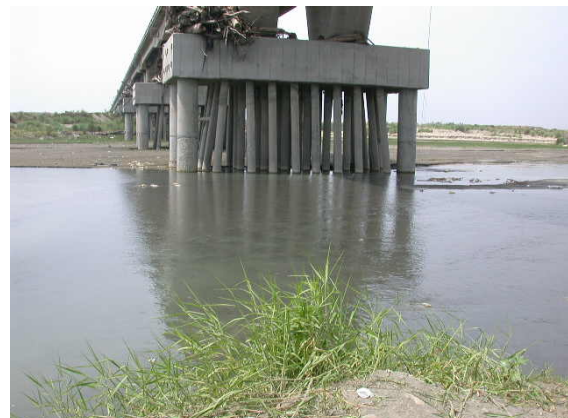
圖 7 橋基產生嚴重沖刷
