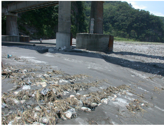
圖 8 牛鬥橋因橋基擴大造成沖刷加深而產生下陷
