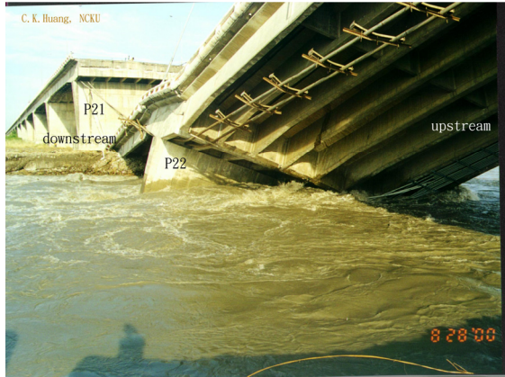
圖 4 高屏大橋斷橋
