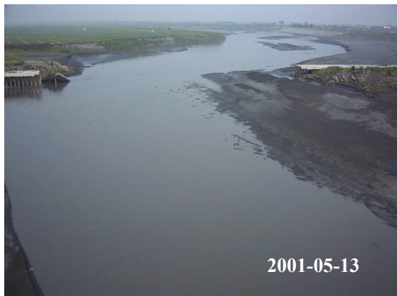
圖 6 自強大橋下游固床工破壞
