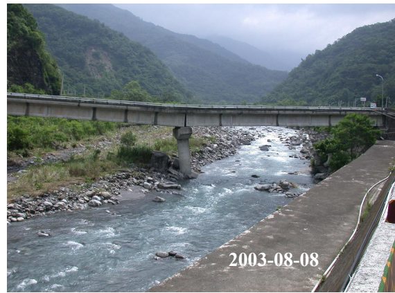
圖 2 義林大橋產生沖刷下陷
