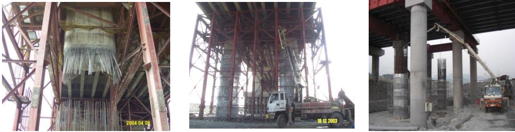
圖 1-2 先拆後建換底工法第二種方式(橋基、墩柱改建) 第三種方式(整體改建)
