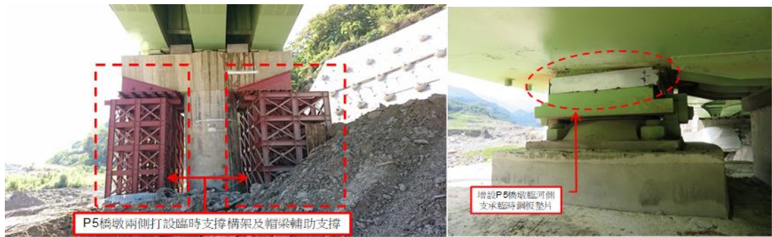
圖 3-2-3 P5 橋墩帽梁底設置臨時重型支撐及支承增設臨時鋼墊片
