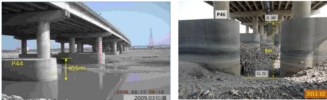
圖 3-1-3 台 63 線烏溪橋基礎被沖刷最大裸露長度高達 8 公尺
