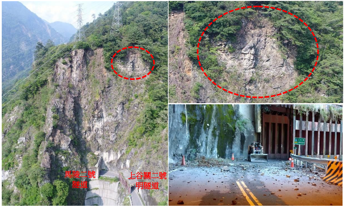
照片 3 台 8 臨 37 線 1k+830 路段空拍及落石狀況
