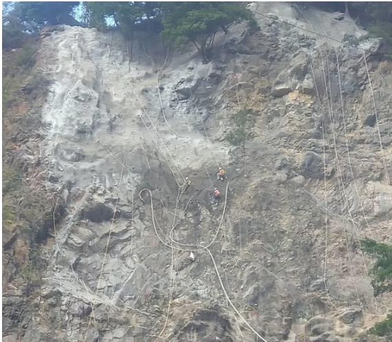
(1) 明隧道施工前處理邊坡浮石危害
