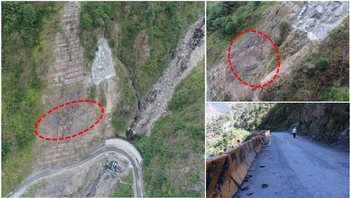
(1) 台 8 臨 37 線 7k+900 路段空拍及現地情形
