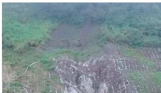
照片B4 26k+100上邊坡整治範圍頂部有新崩塌
