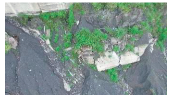
照片B6 26k+100下邊坡崩塌裸露設施損壞
