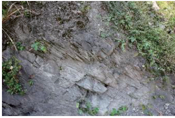
照片 A10 台 7 甲線 26K+400 道路下邊坡坡趾出露之板岩
