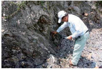
照片 A11 台 7 甲線 27K 道路下邊坡坡趾出露之板岩
