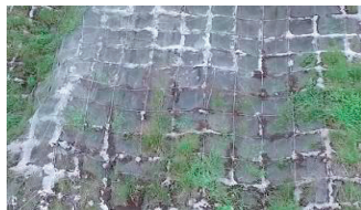
照片B5 26k+100上邊坡坡面型框損毀
