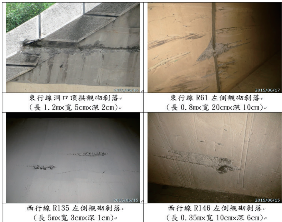
圖 4-18 隧道襯砌剝落之調查照片
