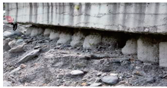
照片B8 護岸擋牆之排樁遭沖刷導致鋼筋出露
