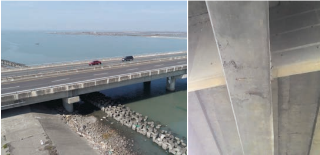
圖 1 預力梁底鋼筋銹蝕混凝土爆裂
