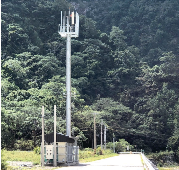
照片 11 中橫便道內新設 4 座不斷電柴油基地台（本座位在青山會車點旁）
