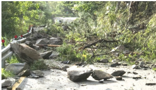
(3) 巡查後遇落石阻斷情形
