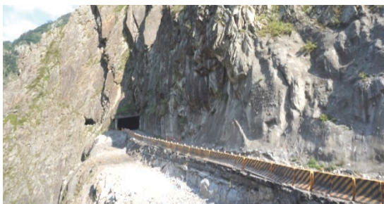
(2-1) B2 標 3k+700 上邊坡為高聳裸坡
