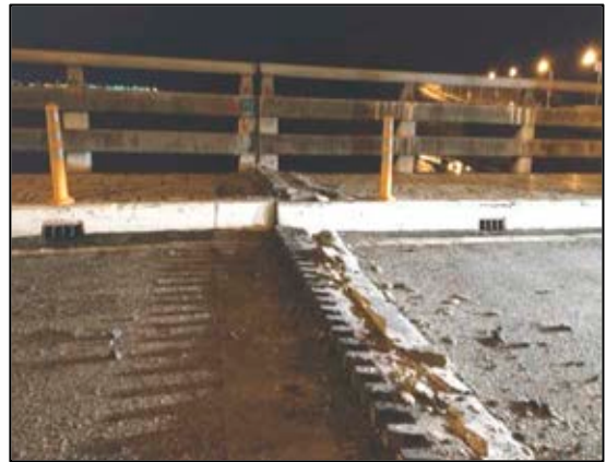
圖 7 台 11 線 花蓮大橋北上 p12 伸縮縫擠壓翹曲
