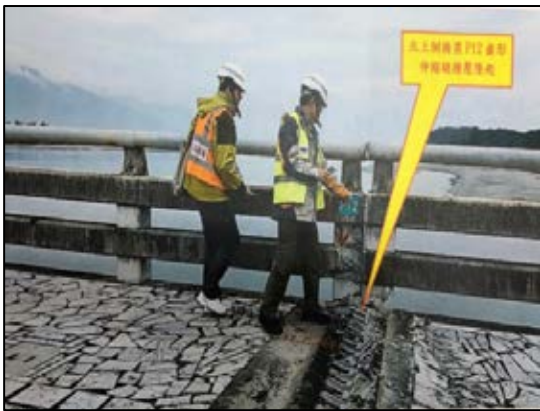
圖 22 CECI 人員現勘花蓮大橋損壞情形
