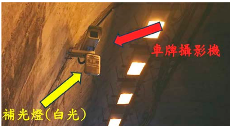
圖 9 現場可辨設備
