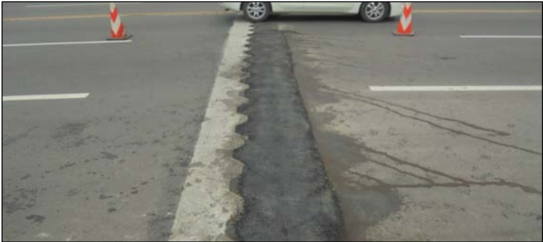
圖 19 中正橋伸縮縫高差修補
