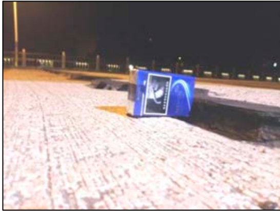
圖 4 台 9 線中正橋 A1 橋台伸縮縫高差
