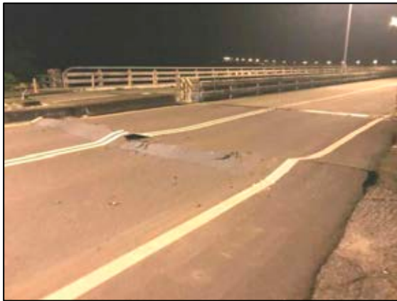
圖 6 台 11 線 花蓮大橋南下 A1 進橋版端路面擠壓隆起
