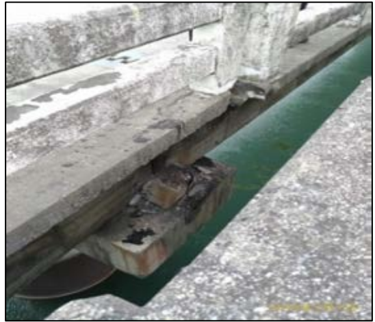
圖 25 P12 一代橋止震塊破裂
