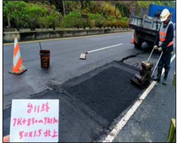
圖 18 台 11 線 7k+850 路面裂縫與修補
