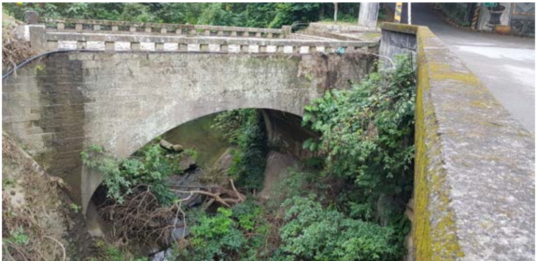
照片 4-1 二代橋原為單孔拱型石橋，後經民國 44 年重建，原拱形石橋下方增建一拱型混凝土結構，增強結構承載力。
