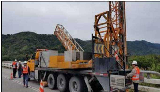
圖 28 搭配橋檢車檢視止震塊損壞情形
