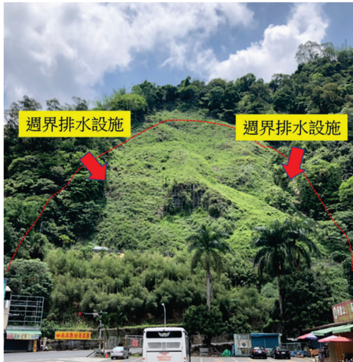
圖 3.8 台 18 線 35k 邊坡評估復建後排水設施之完整性
