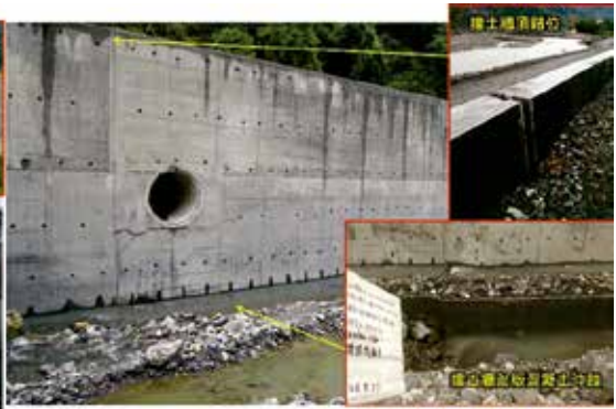
(b) C 標施工中擋土牆受沖刷
