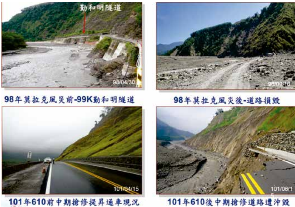
圖 2 台 20 線勤和至復興路段莫拉克風災及 610 水災前後損毀情形
