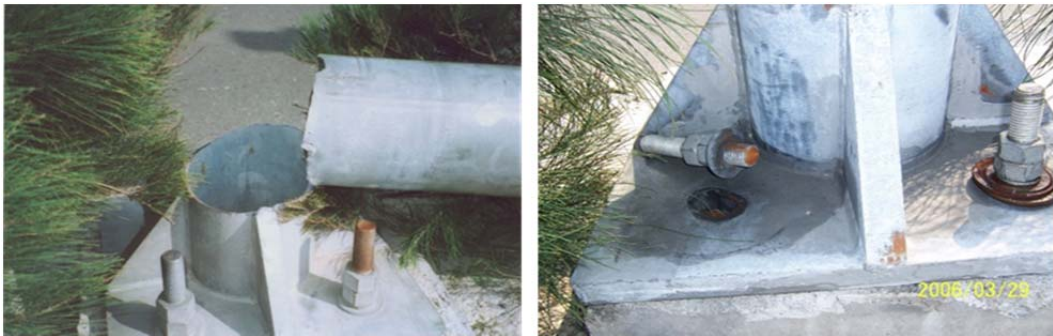
圖 13 舊標誌桿因強風損毀情形
