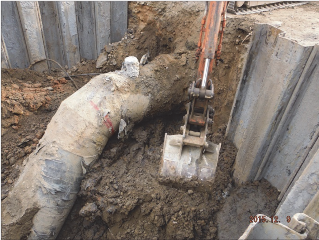
照片 3 沙鹿陸橋主線墩柱 PN5 基礎內水管急降分佈情形
