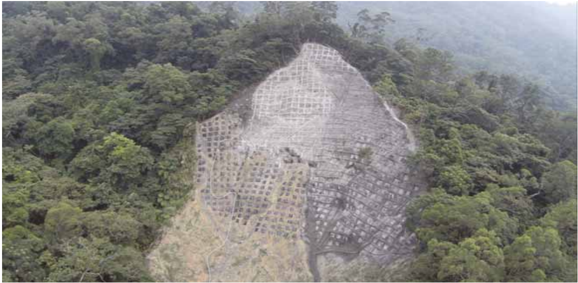
圖 3.4 103.08.29 台 4 線 36K+100 邊坡災害
