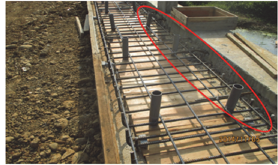
圖 4.4 溝蓋版預留鋼筋彎折(改善前)
