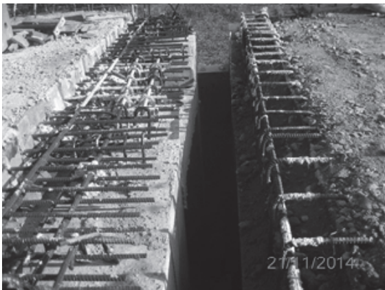
圖 3.1 橋台背牆與預力梁間距過大(改善前)
