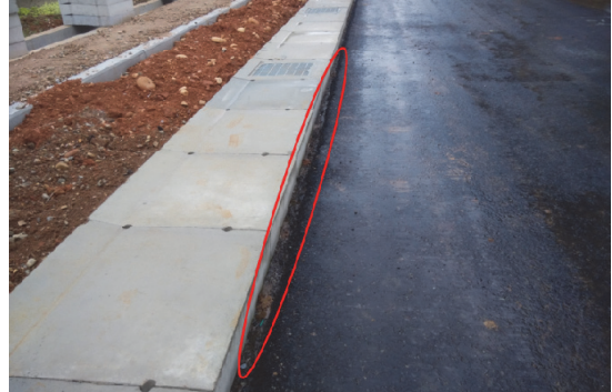
圖 5.2 鋪設瀝青混凝土後再吊放溝蓋版所形 成之縫隙(改善前)
