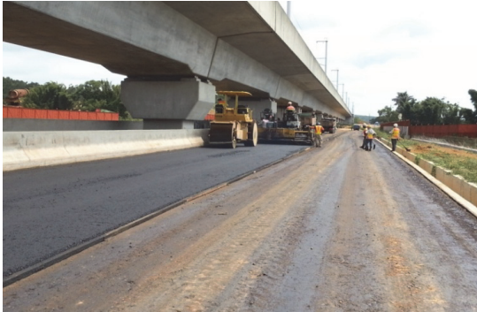
圖 5.1 未吊放溝蓋版即鋪設瀝青混凝土 (改善前)
