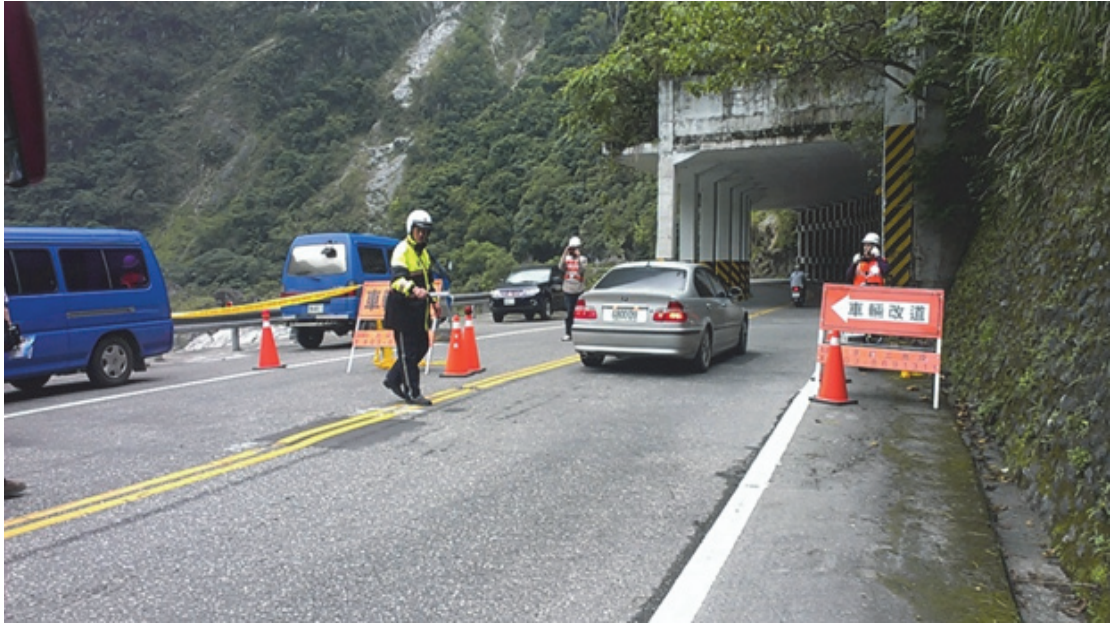
圖 19-2 第一次崩坍初期(102年5月3日14時20分)崩坍落石停歇後每車間隔50m的機動警戒管制放行作業
