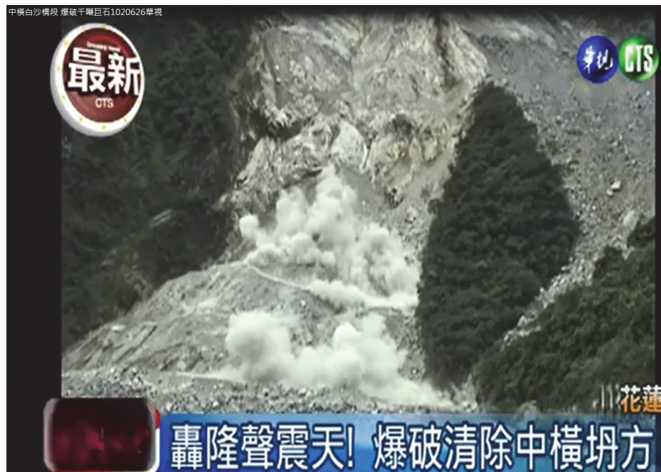
圖 27 媒體報導白沙橋路段搶災作業
