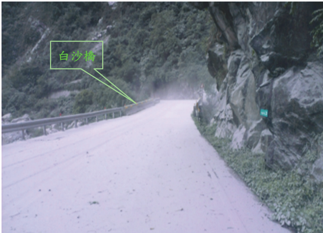
圖 6-1 民國 102 年 5 月 5 日上午 11 時台 8 線 181 k+400 崩坍後粉塵覆蓋路面，厚度超過 2 cm
