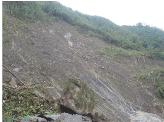
圖 18 下邊坡地層裸露
