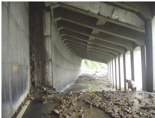
圖 17 明隧道下陷及側移擠壓破壞
