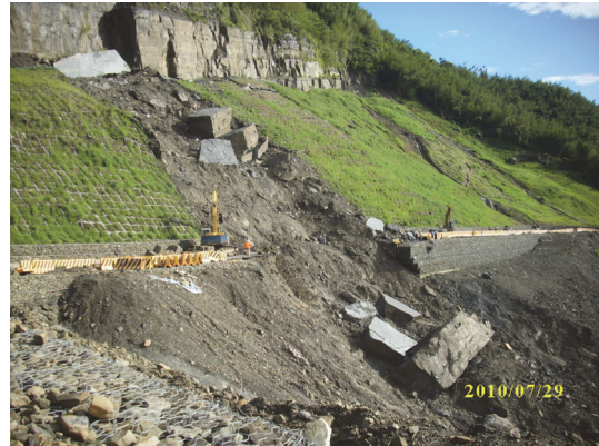
上邊坡岩盤翻倒破壞
