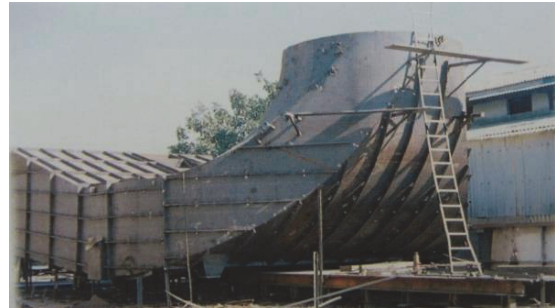
照片 4 水力發電設備 (大將作鋼構)
