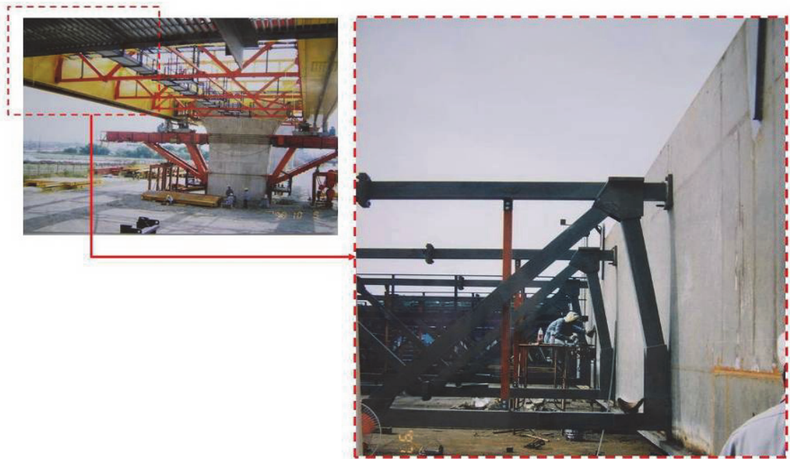
照片 22-1 支撐先進工作車支撐桁架與主梁接合處
