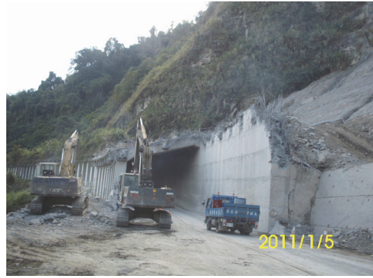
59K 明隧道受損部分打除
