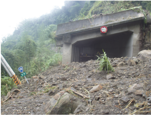
59K 明隧道下陷及側移擠壓破壞
