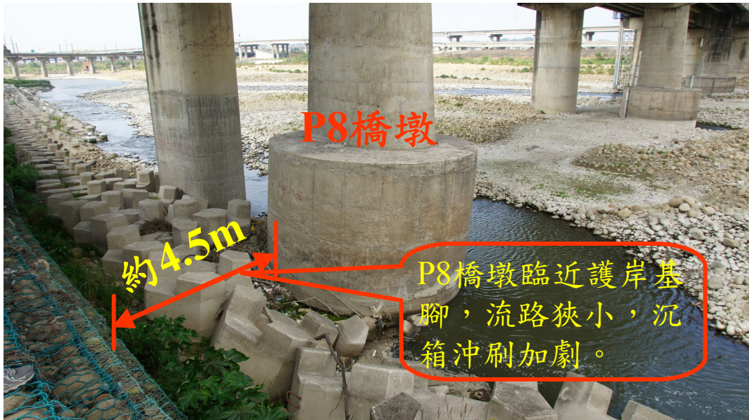
照片 2-2 舊橋 P8 沉箱裸露情形
