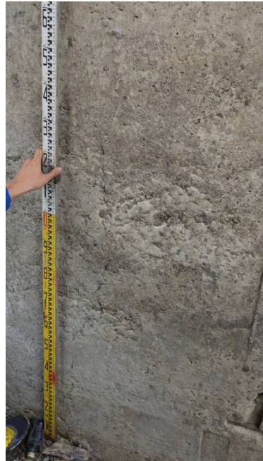
P8-2 沉箱混凝土垂直裂縫
