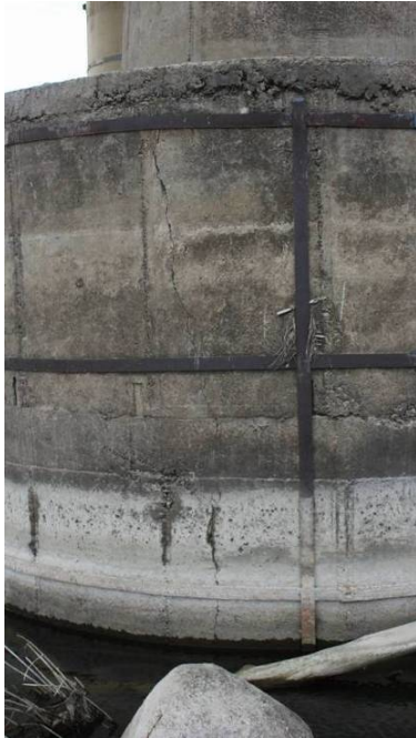
P6-1 沉箱混凝土垂直裂縫
