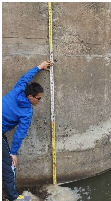
P8-1 沉箱混凝土垂直裂縫
