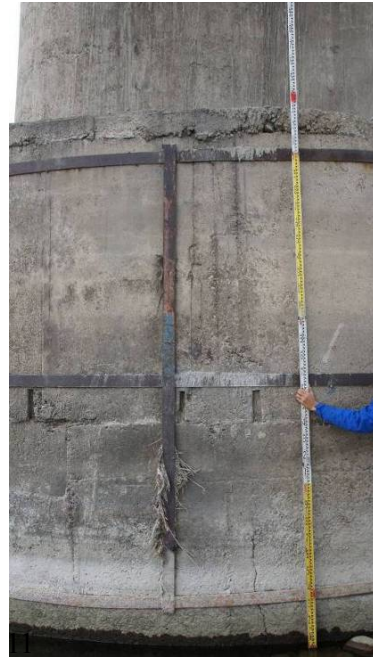
P7-1 沉箱混凝土垂直裂縫
