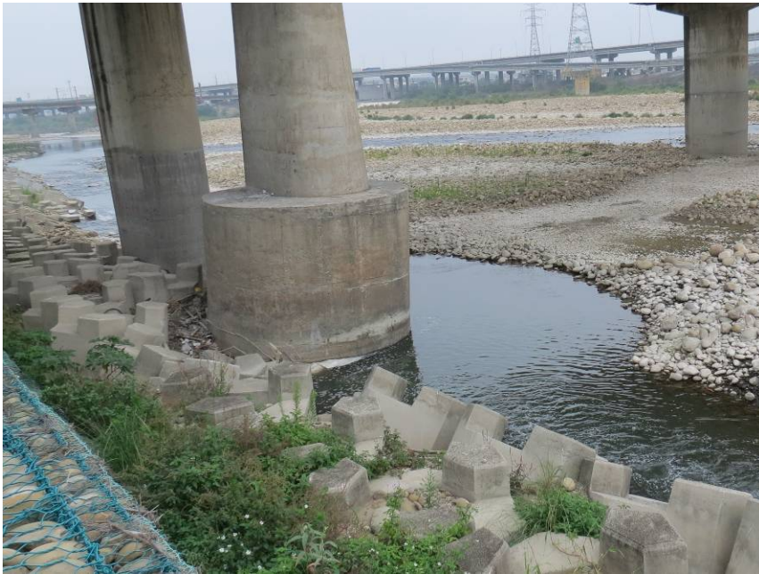
照片 3-2 北勢大橋上、下游及 P8 馬蹄沖刷坑情形 (由上而下)
