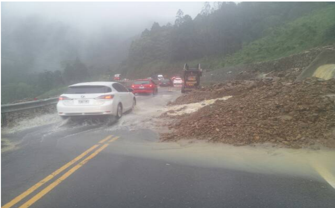
圖 5-2-2 阿里山公路高海拔 82k+500 於 2013 年 05 月 19 日受豪雨誘發崩塌岩土泥塊先清 一半先通車的現場施工中實景圖(陳威安當日 11 時拍攝)
