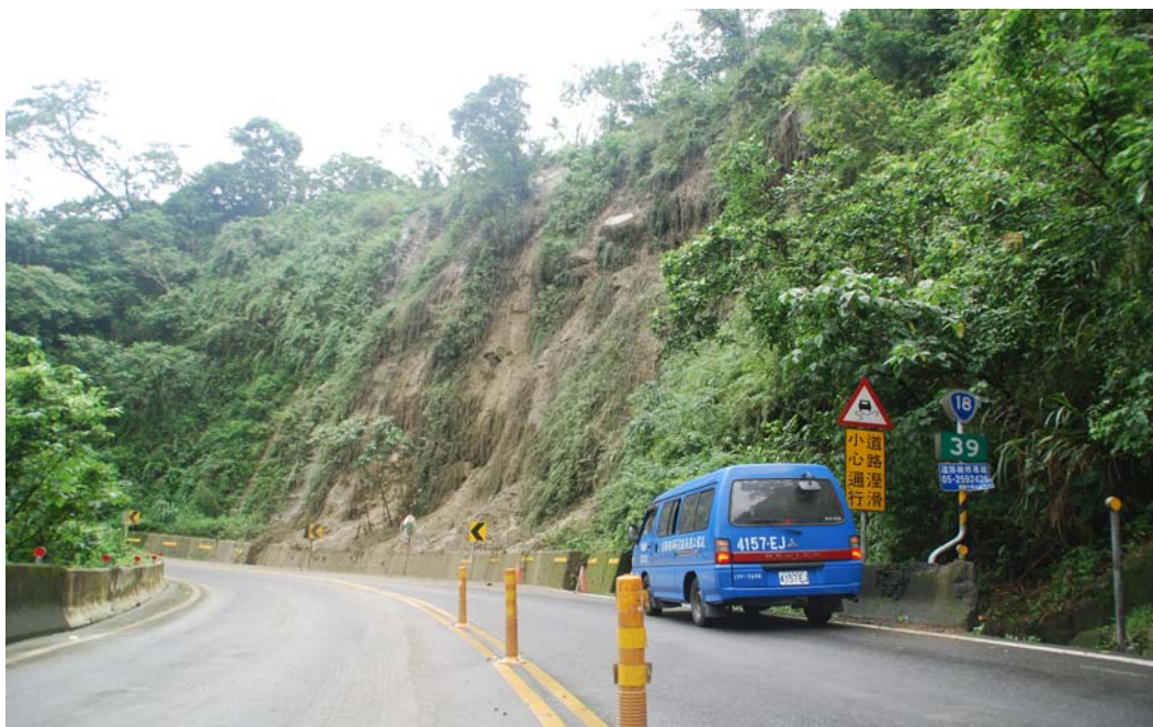
圖 5-2-5 阿里山公路 39k 在 2013 年 05 月 17 日邊坡崩塌泥流施工前實況圖 (賴明煌當日 12 時拍攝)
