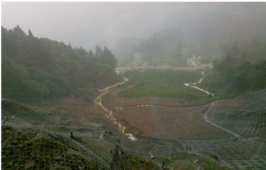
圖 5-2-3 阿里山公路高海拔 82k+500 於 2013 年 05 月 19 日豪雨誘發崩塌岩土泥塊從上端 500m 處看其交通封閉正進行清理的現場施工實景圖(賴明煌當日 11 時拍攝)
