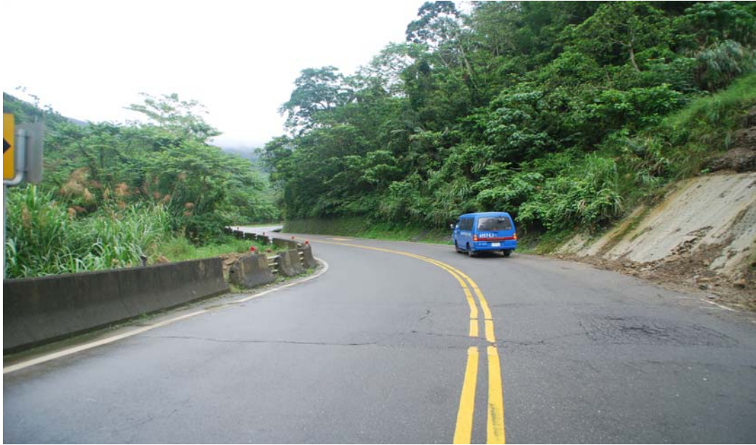
圖 5-2-9 阿里山公路 38k+700 阿里山公路在 2013 年 05 月 17 日邊坡崩塌礫石夾泥砸下傷害漿砌卵石護坡與塌石暫清通置放下邊坡護欄外實況圖(賴明煌 11 時 30 分拍攝)
