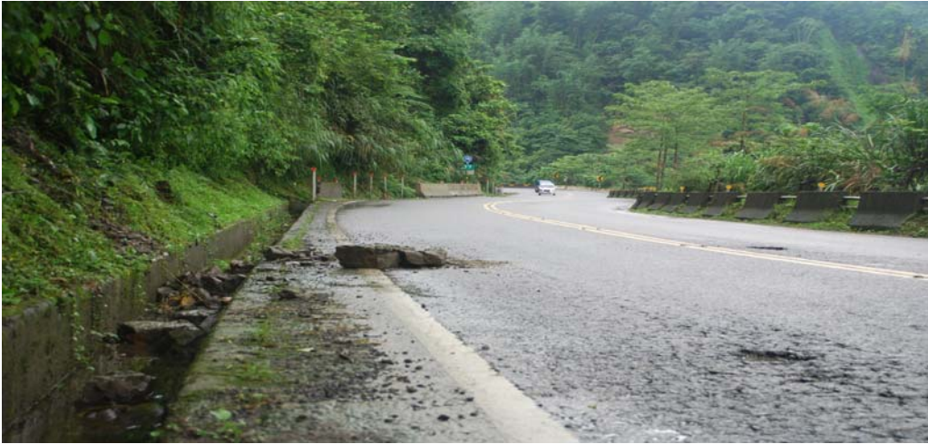
圖 4-3-1-1 阿里山公路 37k+100 在 2013 年 05 月 17 日 11 時的零星小崩塌落石會有略為妨礙正常行車之情況。(賴明煌拍攝)
