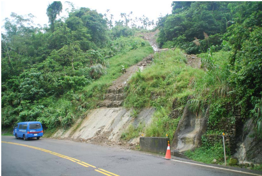
圖 5-2-8 阿里山公路 38k+700 在 2013 年 05 月 17 日邊坡崩塌礫石夾泥砸下傷害漿砌卵石護坡與設置交通錐實況圖(賴明煌 11 時 30 分拍攝)
