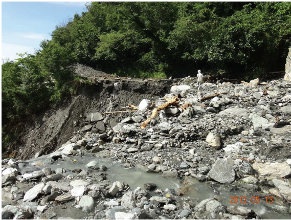
7.台9線 144K+750~+800 路基缺口-1
