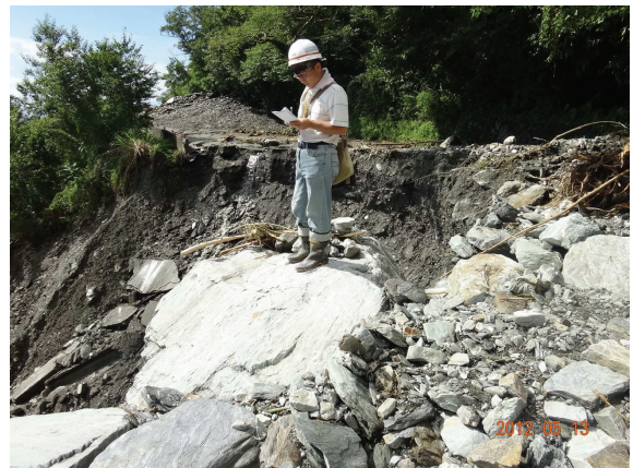
10.台9線 144K+750~+800 路基缺口-4
