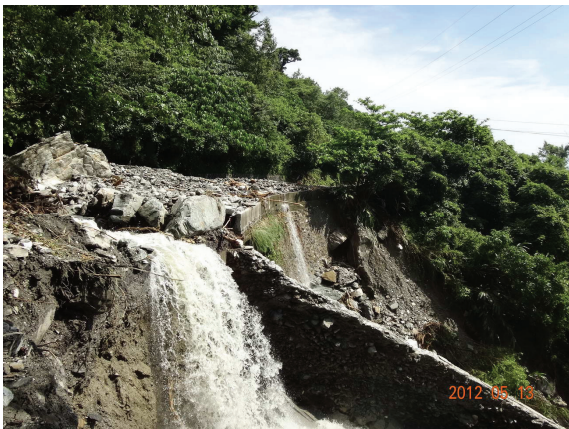
9.台9線 144K+750~+800 路基缺口-3
