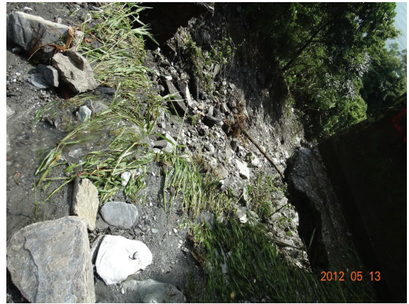
6、台9線 144K+590 路基缺口-4
