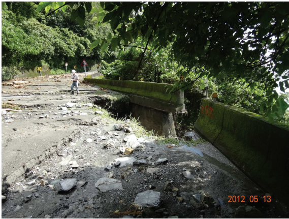
5.台9線 144K+590 路基缺口-3
