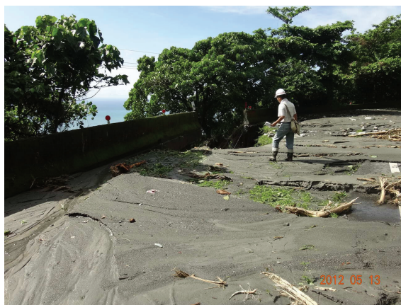
4.台 9 線 144K+590 路基缺口-2
