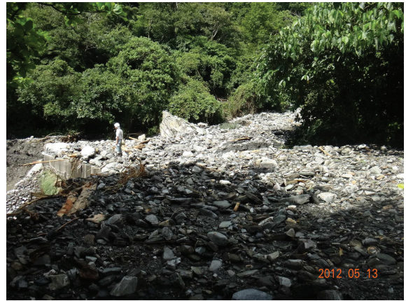
8.台9線 144K+750~+800 路基缺口-2
