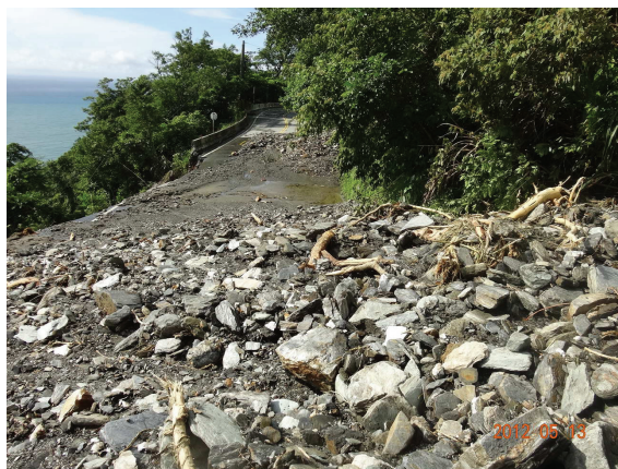
2.台 9 線 143K+940~+970 路基缺口-2
