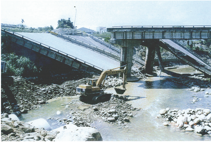
圖 1 921 集集大地震石圍橋落橋破壞情形
