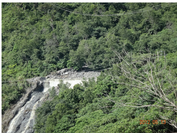
3.台 9 線 144K+590 路基缺口-1
