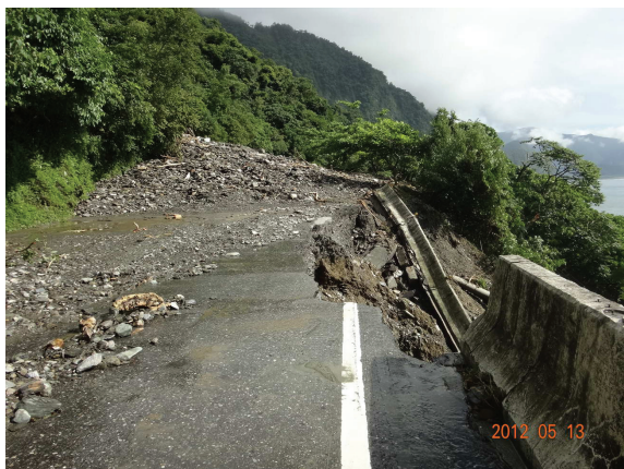
1.台 9 線 143K+940~+970 路基缺口-1
