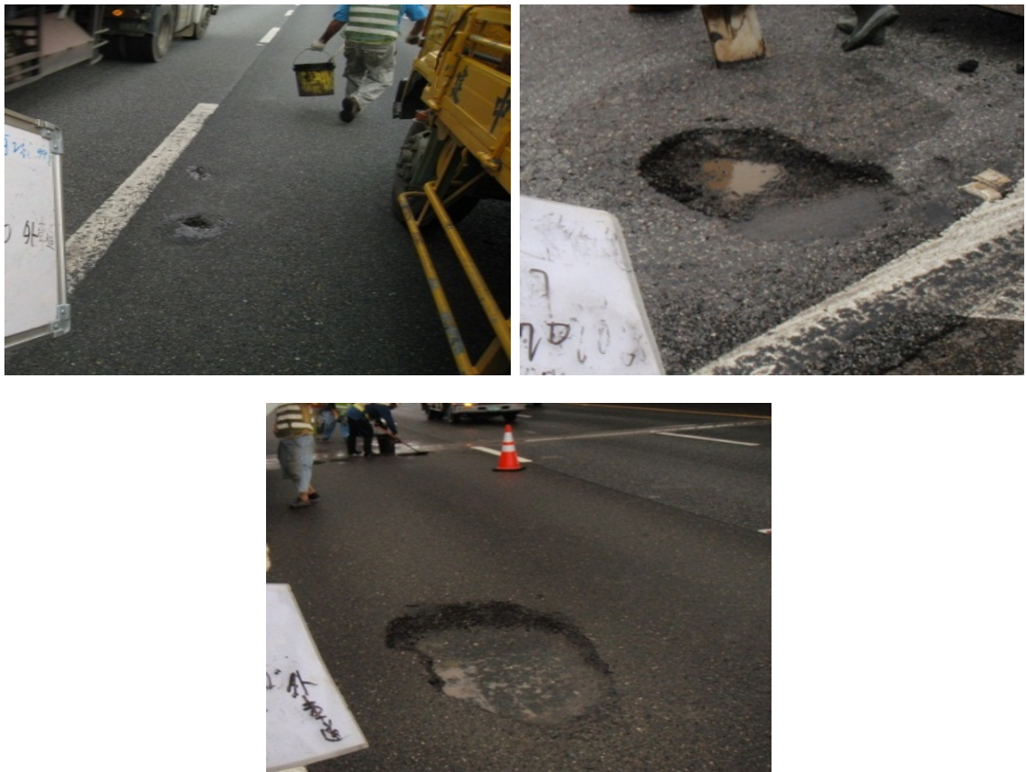
圖 3.3.15 由左至右分別是輕度坑洞、中度坑洞、重度坑洞
