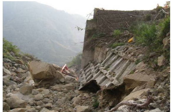
原橋墩加固護岸受損嚴重
