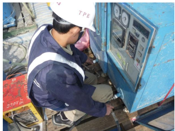
圖 32 灌漿記錄設備
