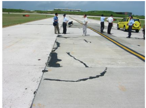
第二版塊:角隅破壞
