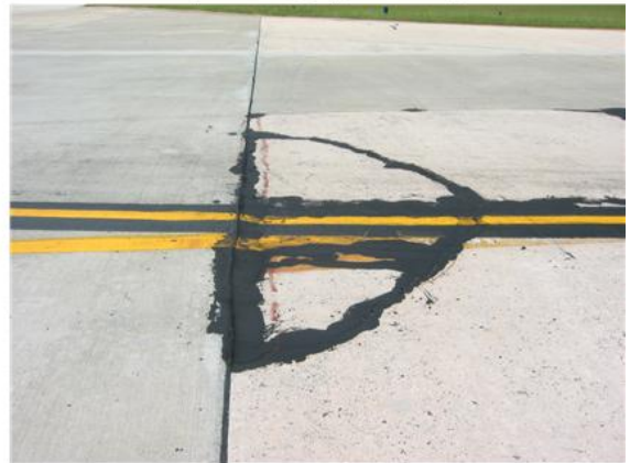
第三版塊:角隅破壞+中央裂縫
