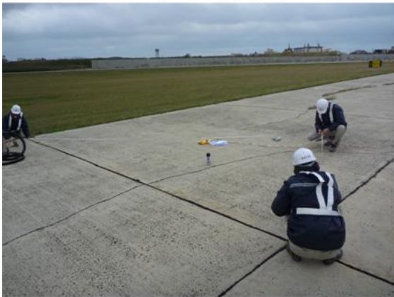
版塊1B:角隅破壞
