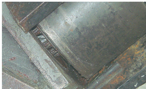
照片-2 變曲點：錨頭與承壓底板分離
