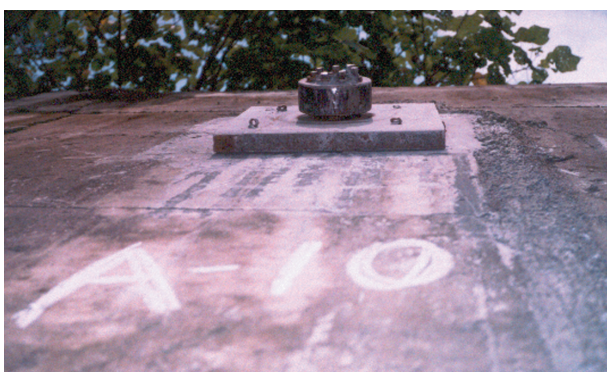
照片-5 A-10 地錨試驗完成後錨頭與承壓底版分離
