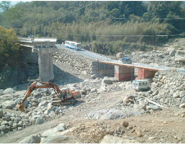
圖38 望鄉橋北側橋墩遭土石流沖毀後僅剩一孔橋面
