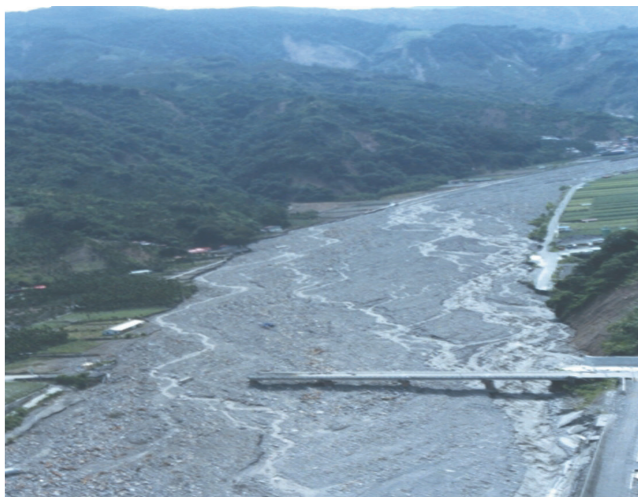
圖09 台21線信義橋遭土石流沖失二孔(空照)
