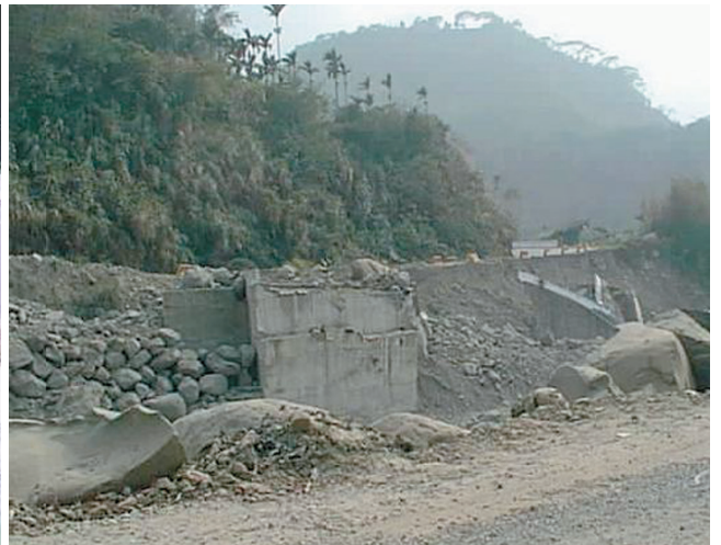
圖95 草瑞公路三龍橋沖毀受災情形
