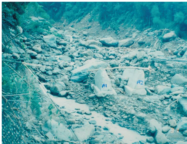
圖62 151線大孝橋遭土石流沖毀僅餘部分橋台
