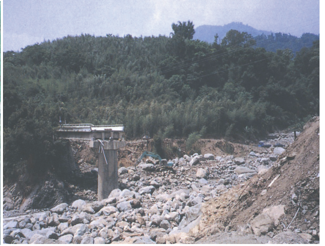
圖37 望鄉橋北側橋墩遭土石流沖毀後僅剩一孔橋面
