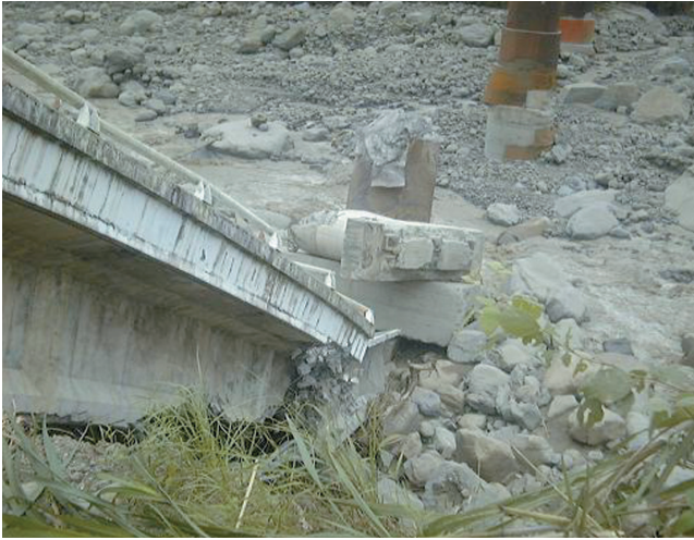
圖102 草瑞公路來吉大橋橋墩沖毀
