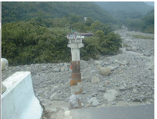
圖101 草瑞公路來吉大橋橋墩沖毀橋面損毀
