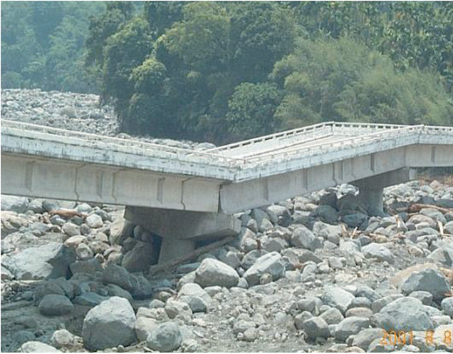
圖90 149甲線全仔社橋受損情形
