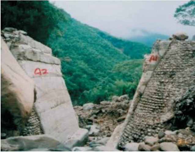
圖66 一五一線大仁橋受損情形
