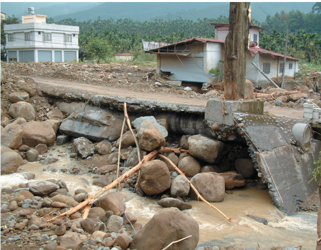
圖50 151線和平橋因土石流造成引道路基、橋台、大梁及橋面損壞
