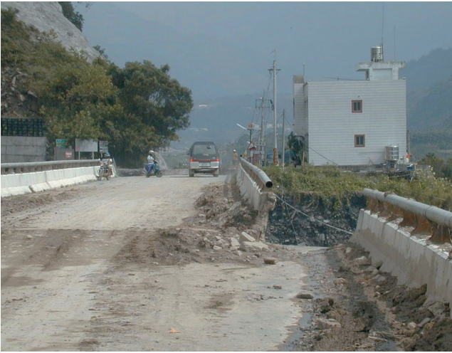
圖19 十八重溪橋北端上部結構受土石流推擠，最大側移量達兩公尺
