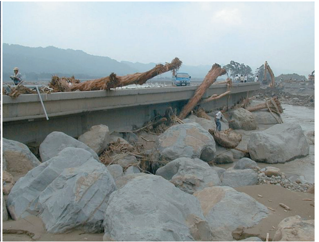
圖73 149線瑞興橋巨石流木堵塞橋孔
