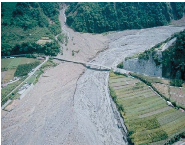
圖17 十八重溪橋北側橋面發生錯移，南側橋台遭土石流沖毀(空照)
