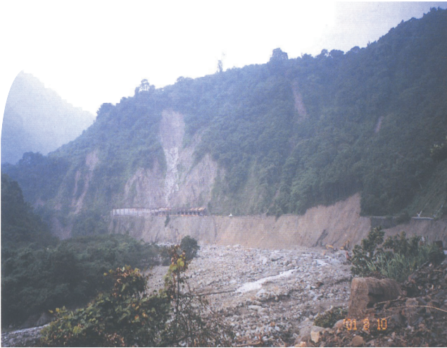
圖42 台21線111K~112明隧道間路基崩塌
