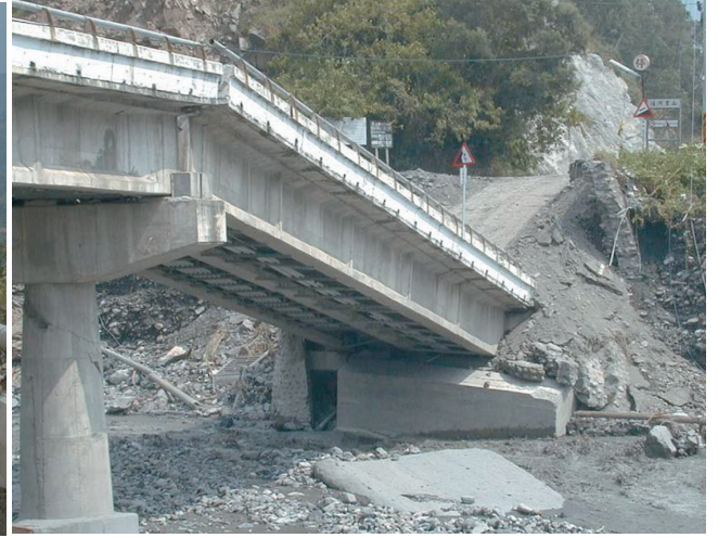
圖20 十八重溪橋南端橋面下落
