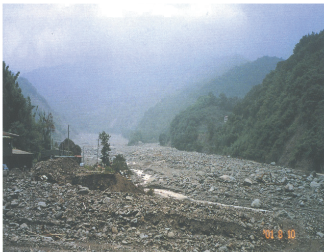
圖44 台21線松泉橋、神和橋完全遭土石流沖失
