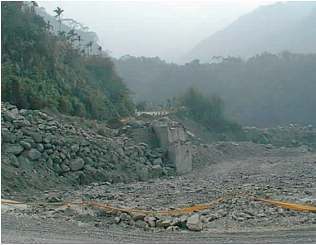
圖96 草瑞公路三龍橋沖毀受災情形
