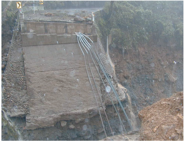
圖53 151線奮鬥橋受損情形
