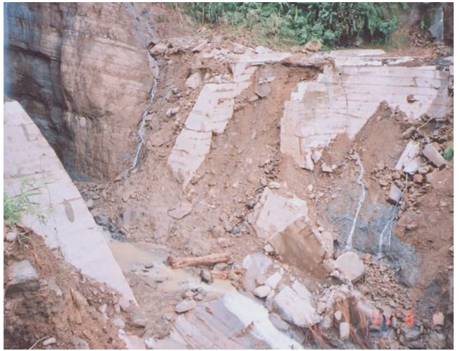
圖85 149 甲線雙孔橋受損情形
