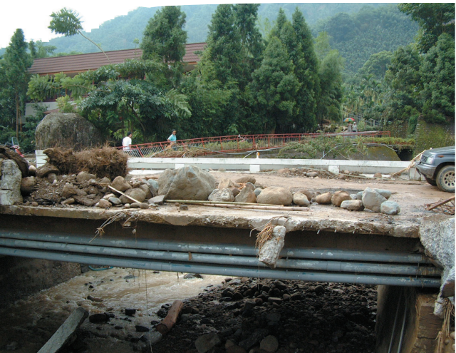
圖52 151線和平橋橋面及護欄破壞
