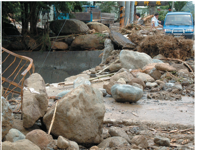
圖51 151線和平橋上游土石流躍上路面及橋面
