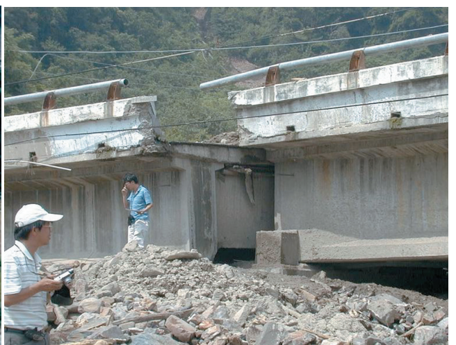
圖18 台21線十八重溪橋北端橋面受損情形
