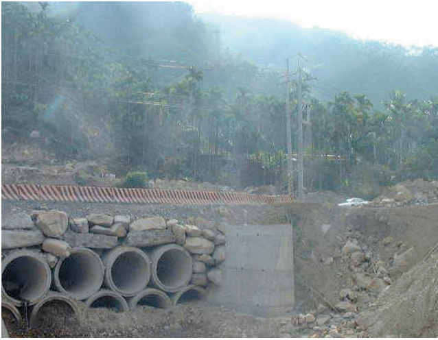
圖01 台21線86K+150處涵洞、路基沖毀，溪槽擴大，目前以涵管便道維持通行
