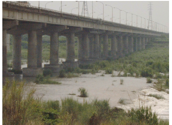
照片 51 里嶺大橋改建前橋基裸露
