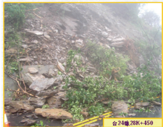
圖 3-11 邊坡崩坍情形（照片來源：三工處）
