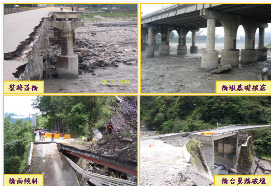
圖 3-9 橋梁破壞模式（照片來源：二工處苗栗、台中、谷關段）
