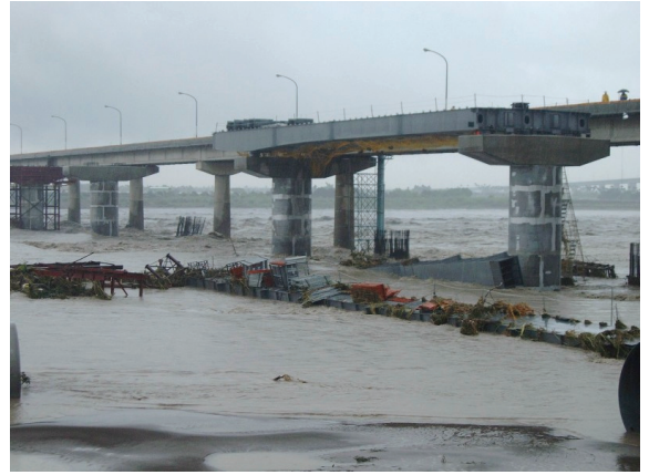
照片 41 雨災鋼箱梁泡水現況
