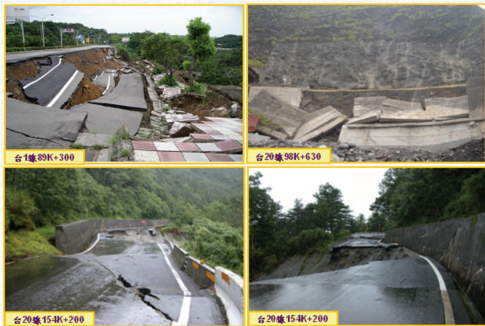
圖 3-5 下邊坡護岸擋土牆崩坍。
