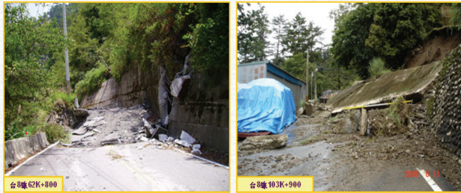
圖 3-4 道路上方邊坡擋土牆破壞圖示。(照片來源：二工處谷關段)
