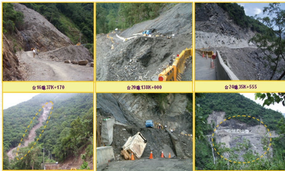
圖 3-6 整體性破壞。(照片來源：二工處信義段、三工處甲仙段、潮州段)
