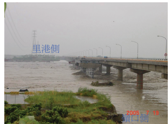
照片 38 94年汛期全工區淹水(三)
