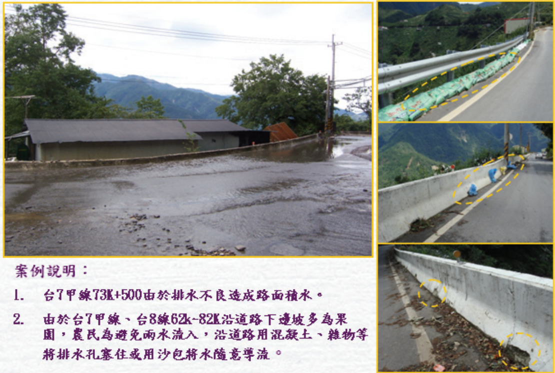
圖 3-14 道路排水不良情形
