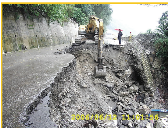
圖 3-7 介面破壞。(照片來源：二工處谷關段)
