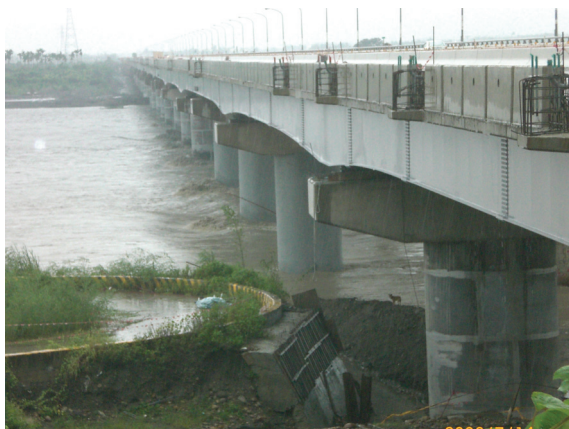
照片 39 95年汛期全工區淹水(一)
