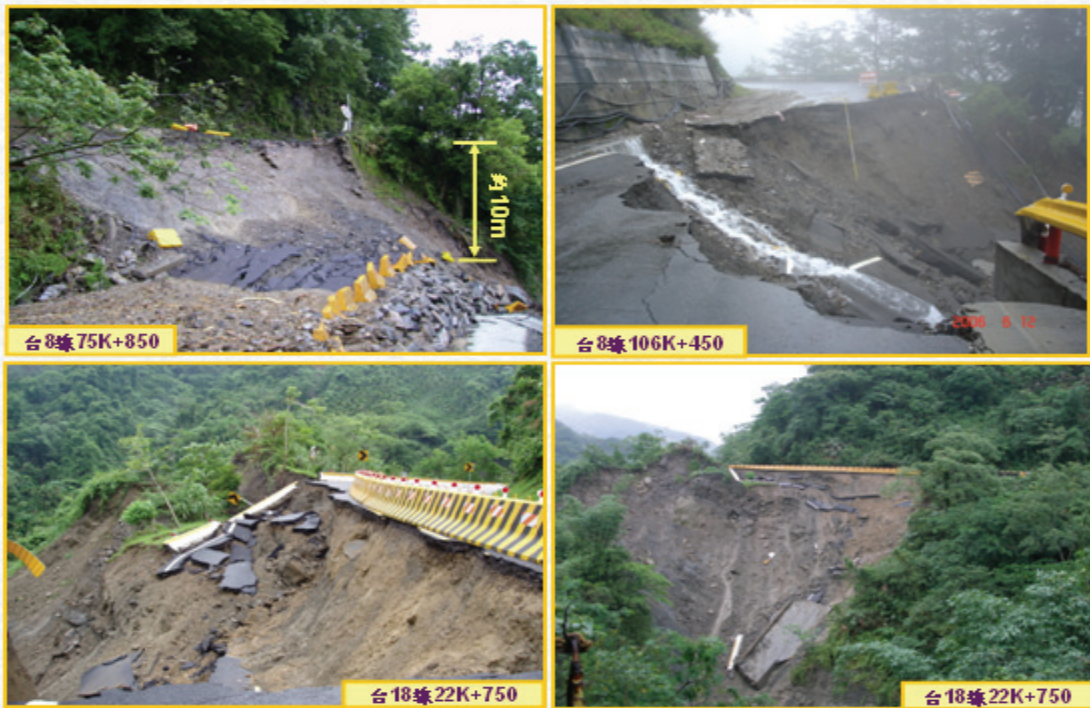
圖 3-3 道路下方邊坡滑動。
