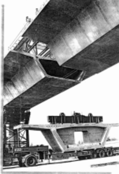
閉合節塊利用板車運至現場等待吊至定位 圖九 高雄支線高架橋
